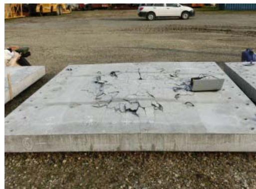
写真-2 供試体全景（劣化部）
