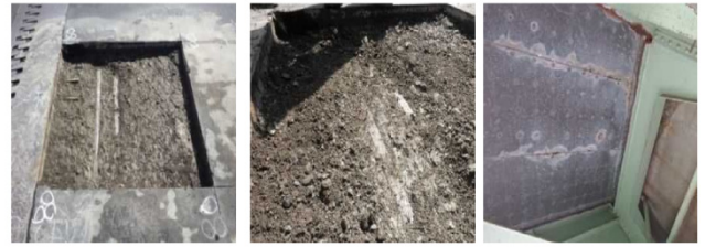
a) 微破壊試験状況(砂利化) b) 床版下面(遊離石灰滲出)
