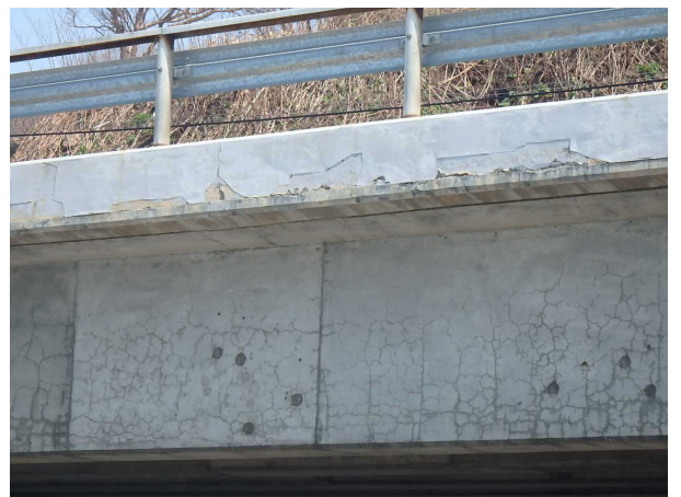
写真-1 損傷状況（最大ひび割れ幅 0.7 mm）
